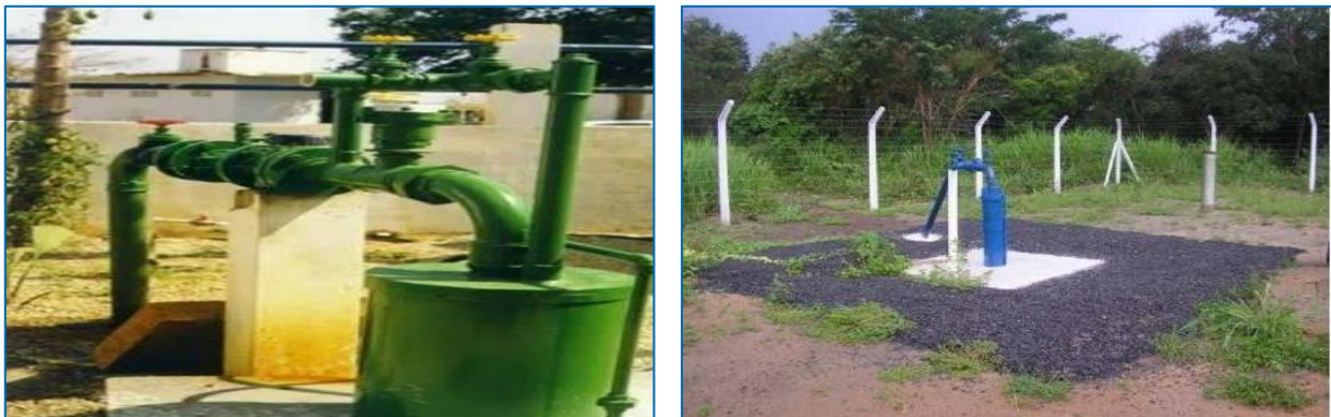
Figura 6. Captação de água em um poço perfurado.
